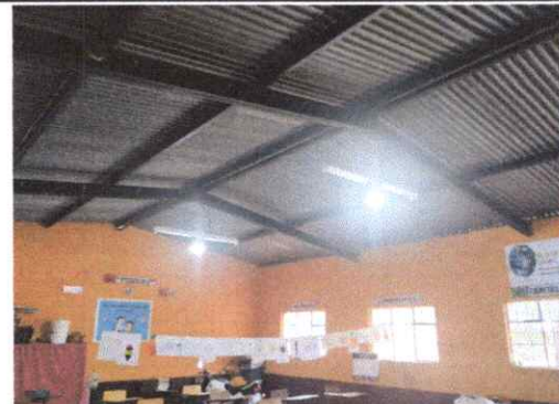
Foto 2. vista interiro de las aulas modulo 1, se propone darle mantenimiento a la estructura portante de metal y pintarlo de color rojo
